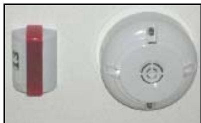
Rilevatore di fumo a soffitto.
