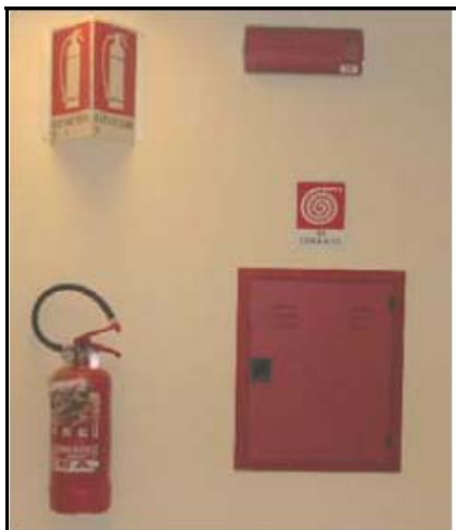
Estintore ed idrante a muro.
