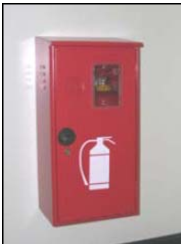
Estintore inserito in cassetta chiusa.
