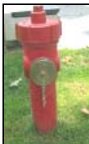
Idrante esterno soprasuolo.
